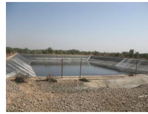
Bassin de récupération des lixiviats
